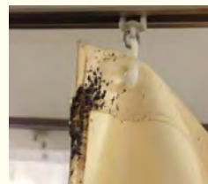
カーテンの被害
