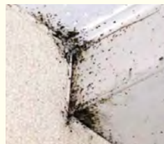
天井や壁の被害
